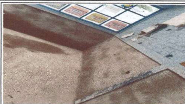
Foto 2: Repello de paredes por hongo.
