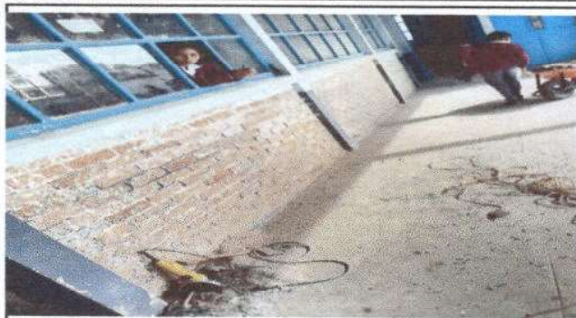
Foto 1: Repello de paredes por hongo.
